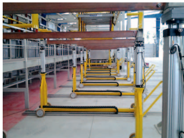
Negli impianti galvanici realizzati da Ilmar, le macchine e le attrezzature montano componentistica pneumatica Aignep
